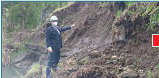
旧笹川中流域(仙台西高付近)の河岸崩落現場。
